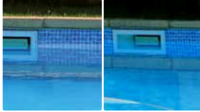
游泳池的排水管道
